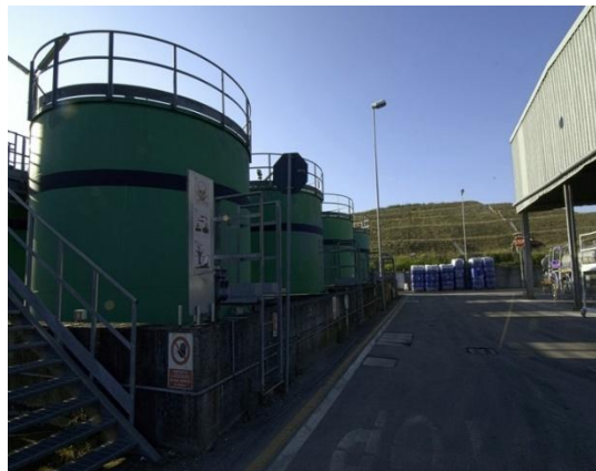
Figura 10 Serbatoi per lo stoccaggio di rifiuti liquidi
