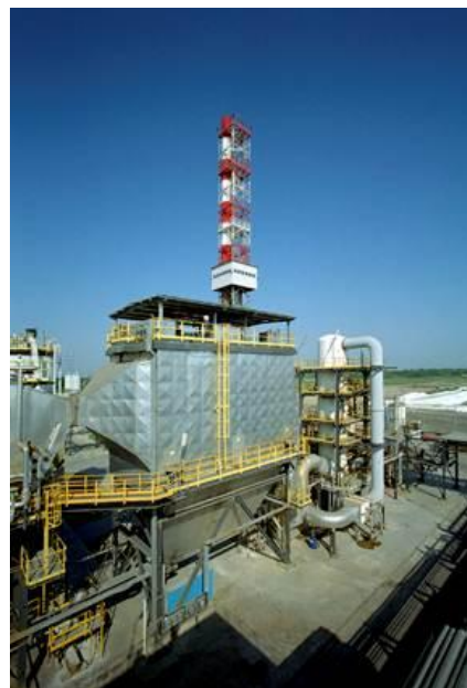
Figura 10 Sezione di depurazione fumi (F3)
