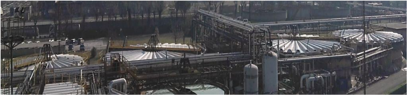
Figura 14 Particolare del trattamento primario
