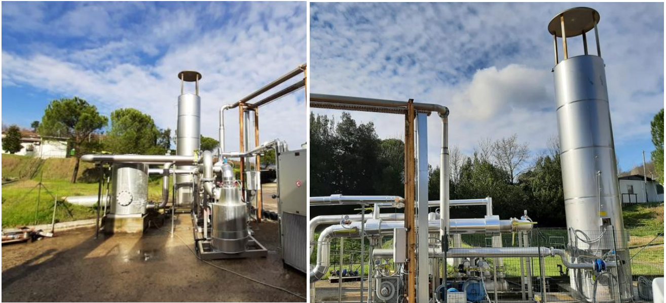
Figura 10 Particolari della nuova torcia
