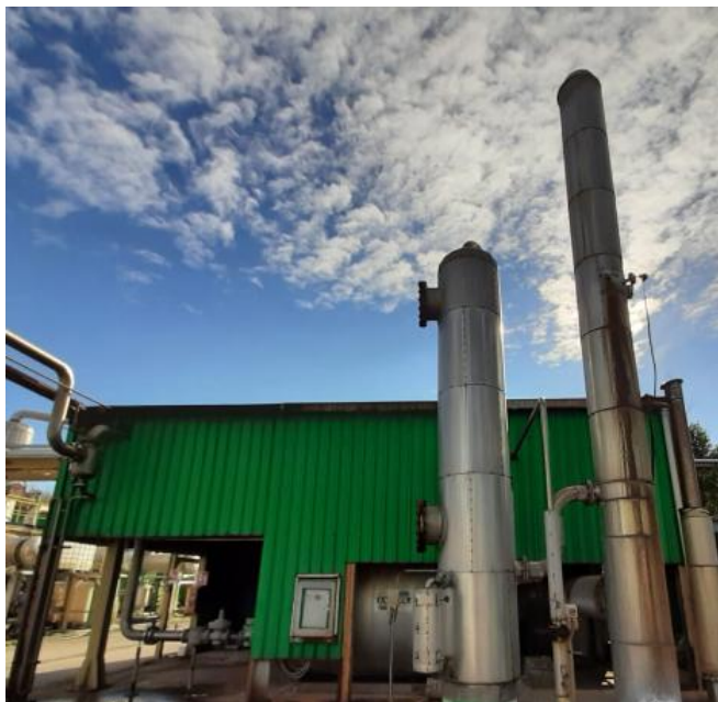
Figura 20 Particolare del punto di emissione della caldaia
