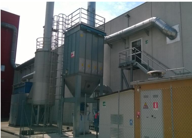
Figura 11 Particolare del filtro a maniche
