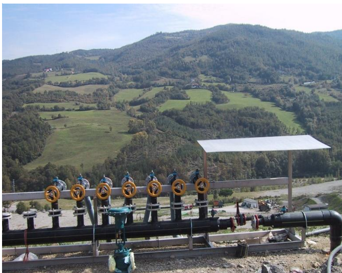
Figura 5 Impianto captazione del biogas
