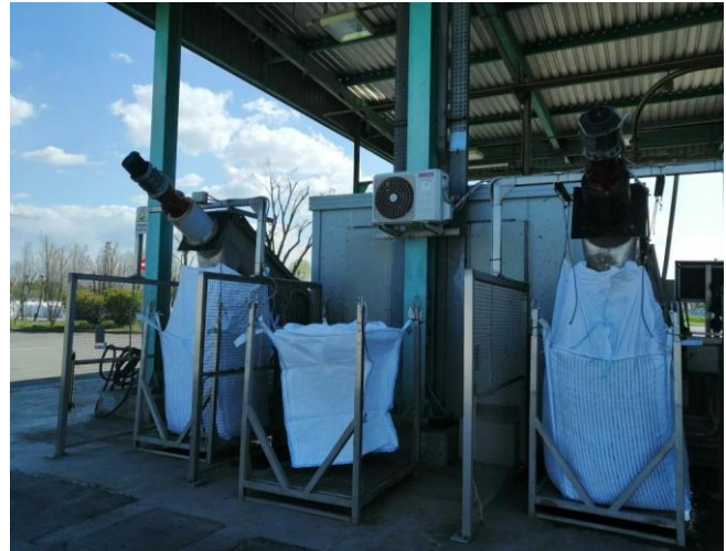
Figura 11 Big bags di raccolta delle sostanze solide provenienti dal processo di dissabbiatura
