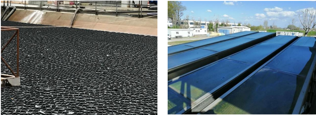
Figura 26 Vasca di sedimentazione primaria con esagoni galleggianti e chiusura completa delle coclee di filtrazione idrodinamica con pannelli in vetroresina
