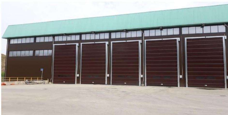
Figura 42 Foto lato sud compartimentazione vasca fanghi pompabili, vista dall'esterno - in cui si evidenzia la totale chiusura del lato, ad eccezione dell'apertura dei portoni durante le operazioni di carico e scarico [Fonte: "Relazione tecnica compartimentazione del 07/08/2019"]
