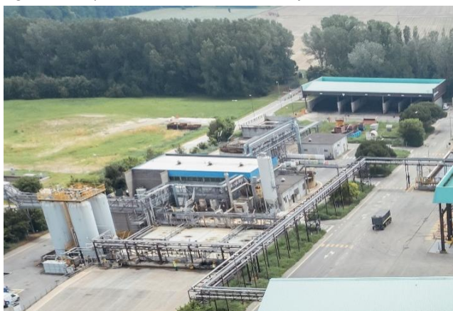
Figura 12 Impianto trattamento chimico-fisico
