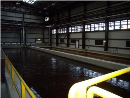
Figura 22 Vasca di stoccaggio fanghi pompabili pericolosi
