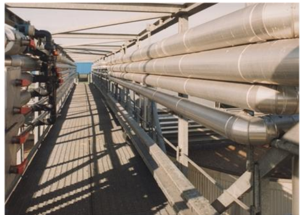
Figura 14 Tubazioni di trasporto del rifiuto liquido in ingresso
