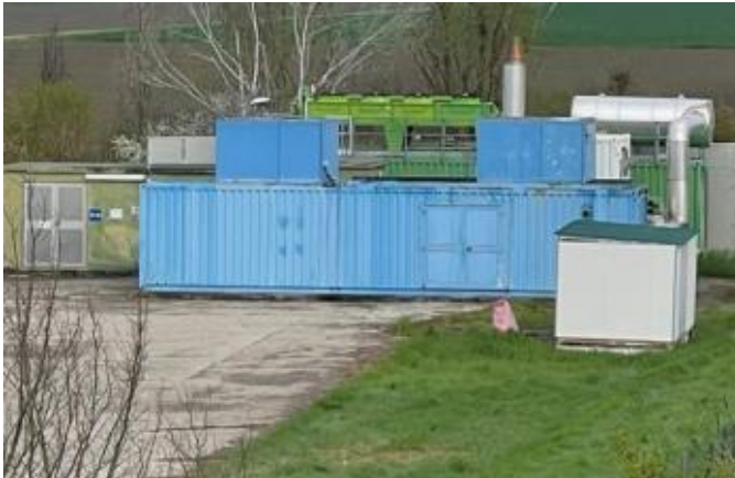
Figura 12 Impianto di produzione di energia elettrica
