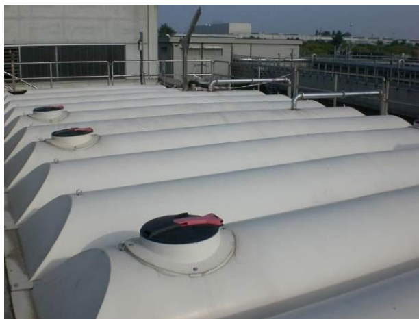
Figura 35 Copertura vasca di stoccaggio VP
