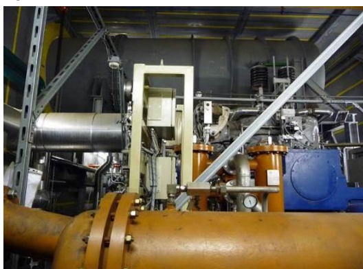
Figura 12 Particolare della sala turbina
