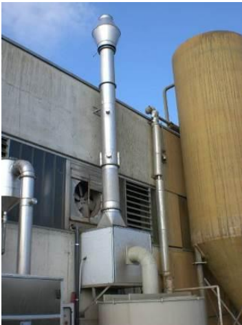
Figura 34 Camino impianto di deodorizzazione
