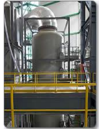
TORRE DI LAVAGGIO FUMI O SCRUBBER
