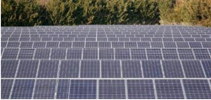
Figura 4 Particolare pannelli fotovoltaici
