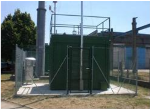
Figura 39 Centralina di monitoraggio qualità dell'aria
