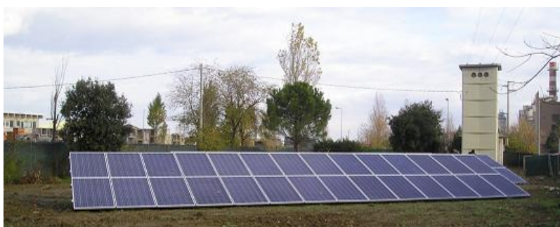
Figura 24 Vista lato Sud-Ovest dell'impianto fotovoltaico
