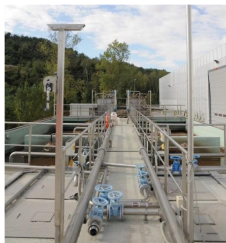
Figura 17 Depuratore biologico interno
