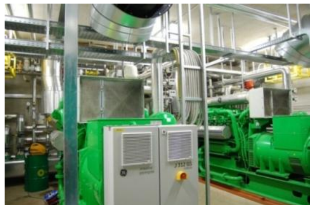
Figura 13 Gruppi di cogenerazione
