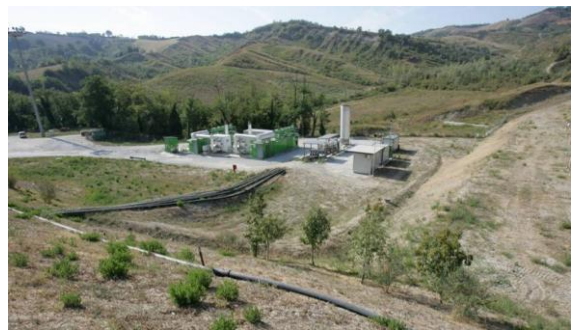
Figura 44 Impianto di recupero energetico
