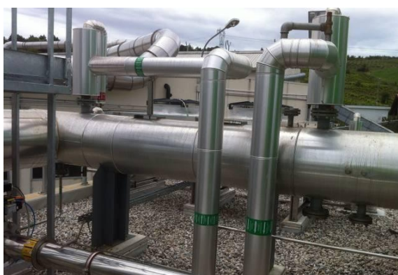
Figura 10 Sistema recupero calore dai fumi
