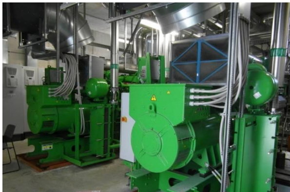
Figura 9 Gruppi di cogenerazione
