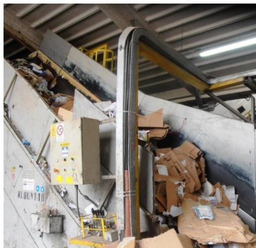
Figura 9 Particolare della pressa
