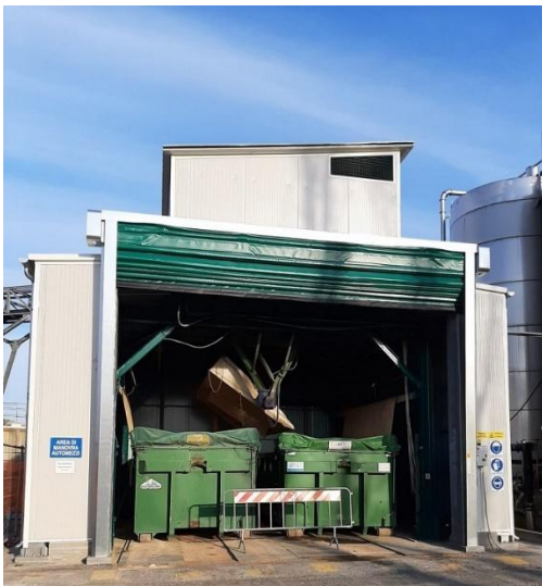
Figura 11 Particolare della filtropressa
