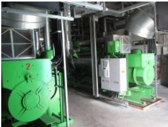
Figura 10 Gruppi di cogenerazione
