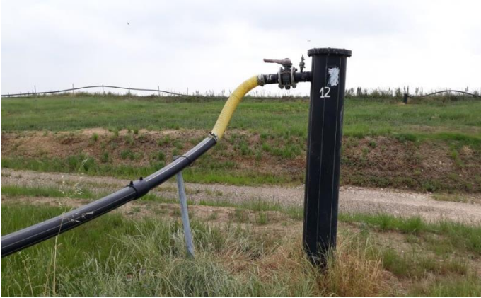
Figura 33 Pozzo di captazione biogas
