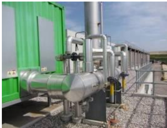
Figura 11 Sistema recupero calore dai fumi
