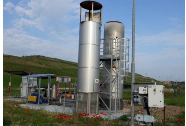
Figura 34 Torcia di combustione biogas
