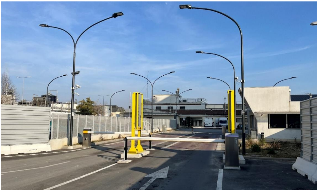
Figura 4 Portale radiometrico e pesa a servizio dell'impianto
