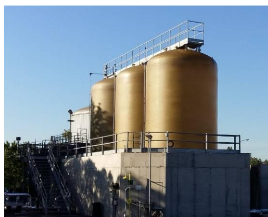
Figura 21 Sistema di accumulo presso Depuratore
