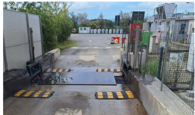
Figura 16 Impianto di lavaggio ruote
