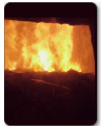
CAMERA DI COMBUSTIONE
