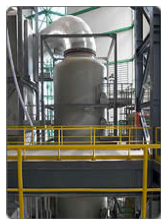
TORRE DI LAVAGGIO FUMI O SCRUBBER
