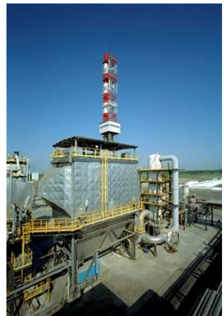
Figura 11 Sezione di depurazione fumi (F3)
