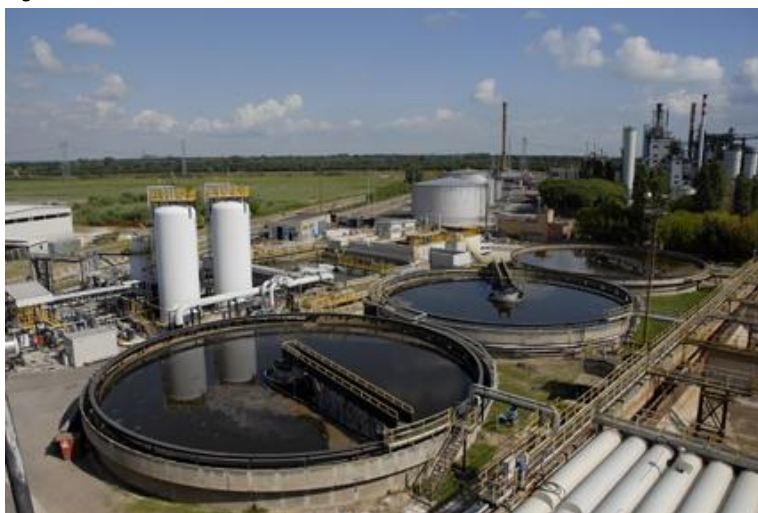
Figura 17 Vasche di sedimentazione
