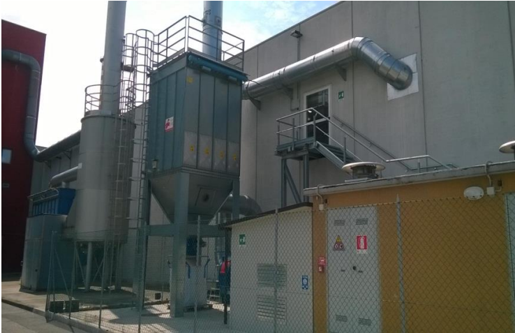
Figura 11 Particolare del filtro a maniche
