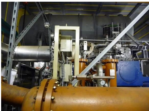
Figura 12 Particolare della sala turbina
