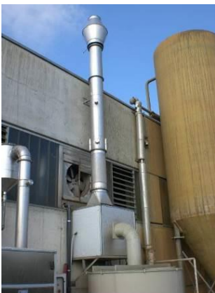
Figura 34 Camino impianto di deodorizzazione
