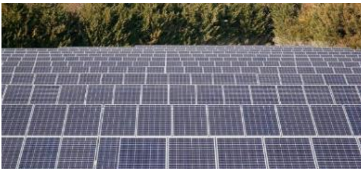
Figura 4 Particolare pannelli fotovoltaici
