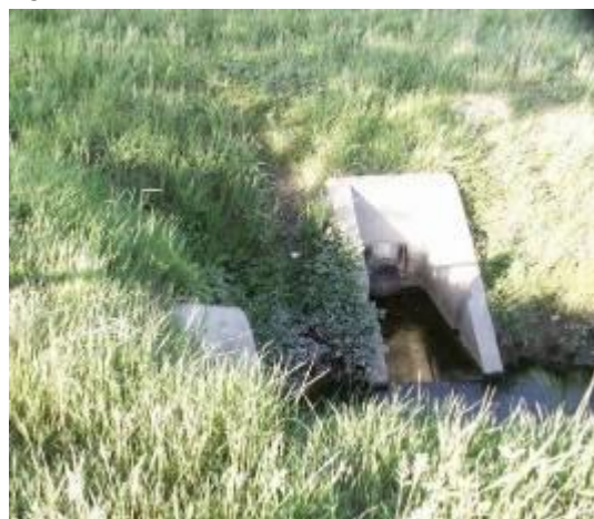
Figura 50 Punto di scarico S1/B
