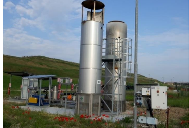
Figura 33 Torcia di combustione biogas
