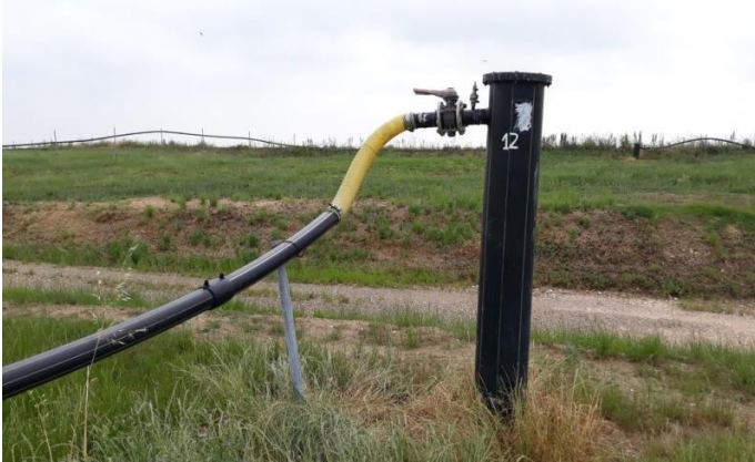
Figura 32 Pozzo di captazione biogas
