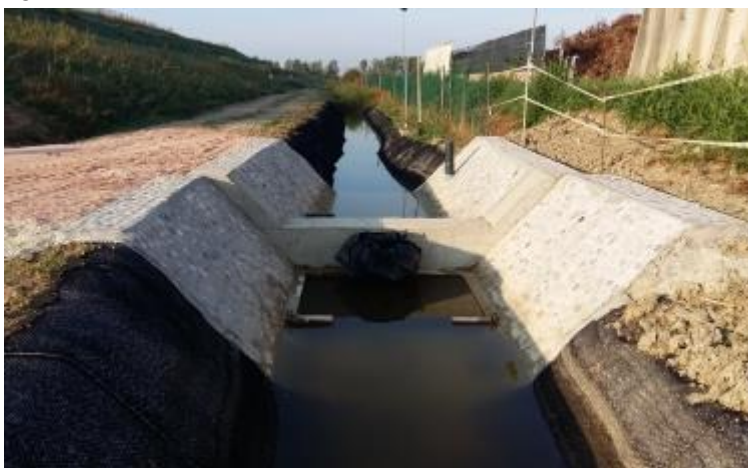
Figura 49 Punto di scarico S1/C
