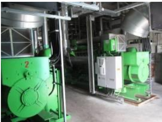
Figura 10 Gruppi di cogenerazione
