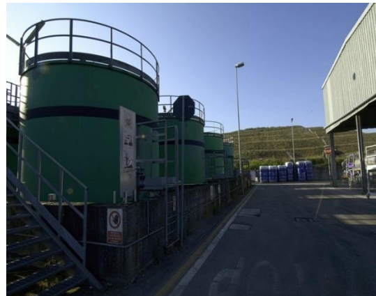
Figura 10 Serbatoi per lo stoccaggio di rifiuti liquidi
