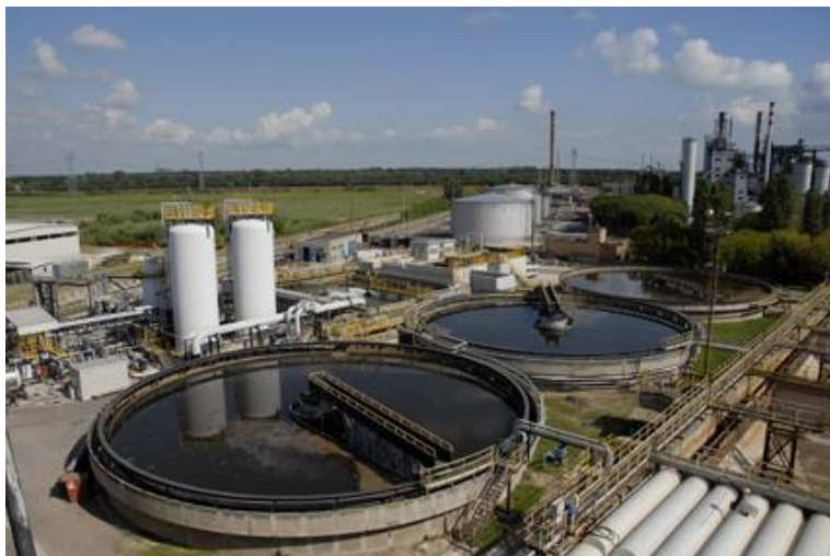
Figura 17 Vasche di sedimentazione
