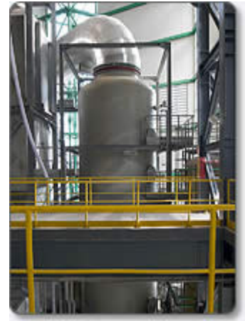
TORRE DI LAVAGGIO FUMI O SCRUBBER
