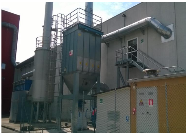
Figura 11 Particolare del filtro a maniche
