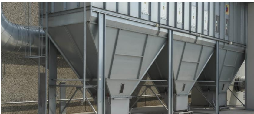
Figura 16 Particolare del filtro a maniche e del punto di emissione
