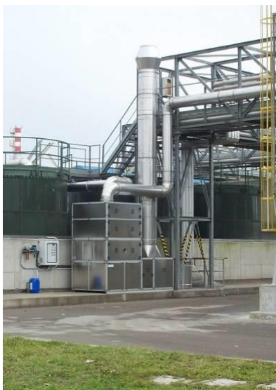
Figura 45 Sistema di trattamento delle emissioni
