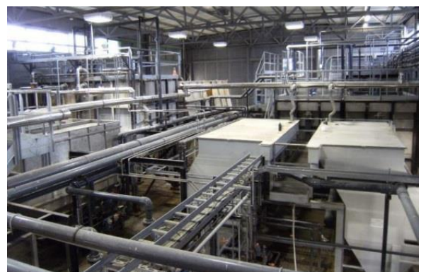
Figura 20 Particolare sezione di trattamento chimico-fisico (1° e 2° stadio)
