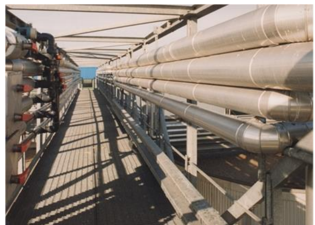
Figura 18 Tubazioni di trasporto del rifiuto liquido in ingresso
