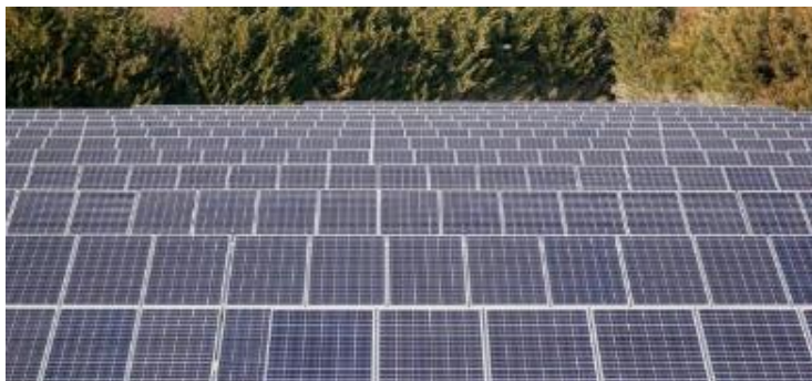
Figura 4 Particolare pannelli fotovoltaici
