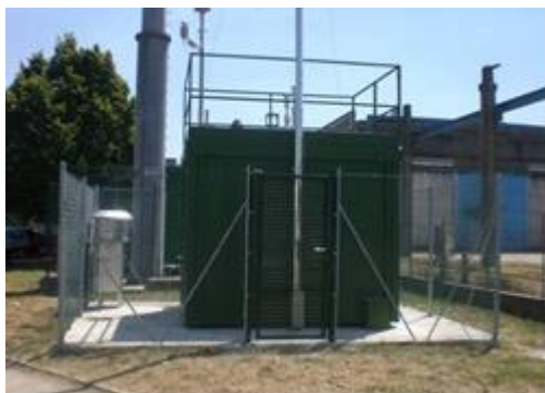
Figura 40 Centralina di monitoraggio qualità dell’aria
