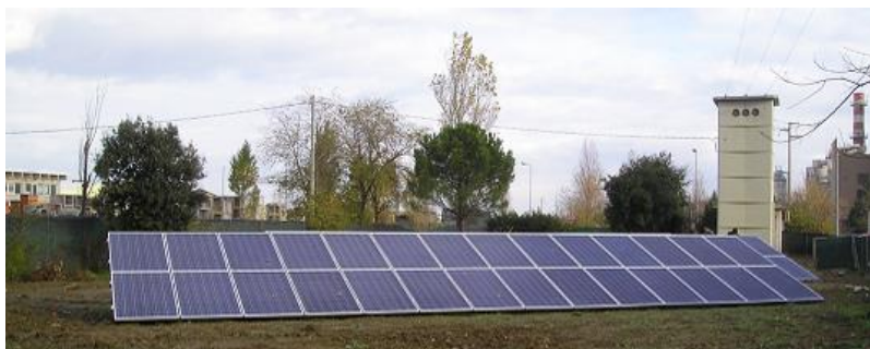
Figura 24 Vista lato Sud-Ovest dell'impianto fotovoltaico
