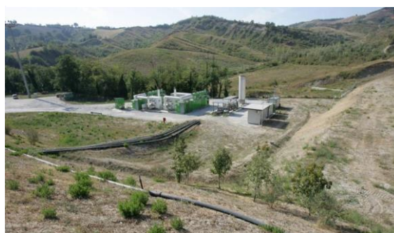
Figura 46 Impianto di recupero energetico
