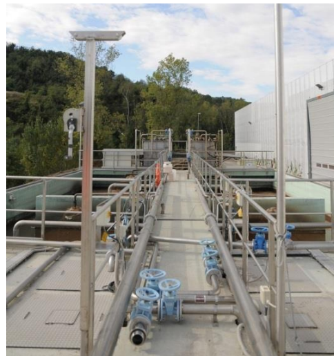
Figura 18 Depuratore biologico interno
