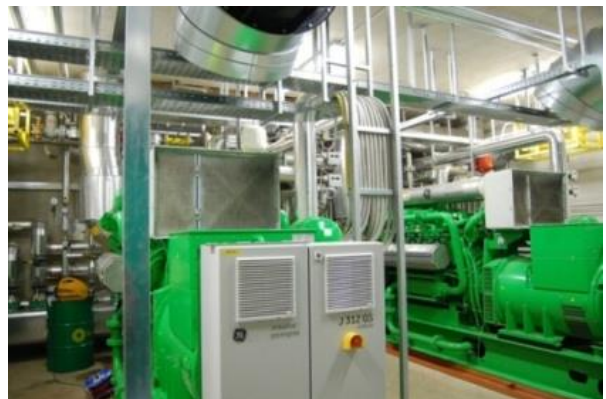
Figura 14 Gruppi di cogenerazione
