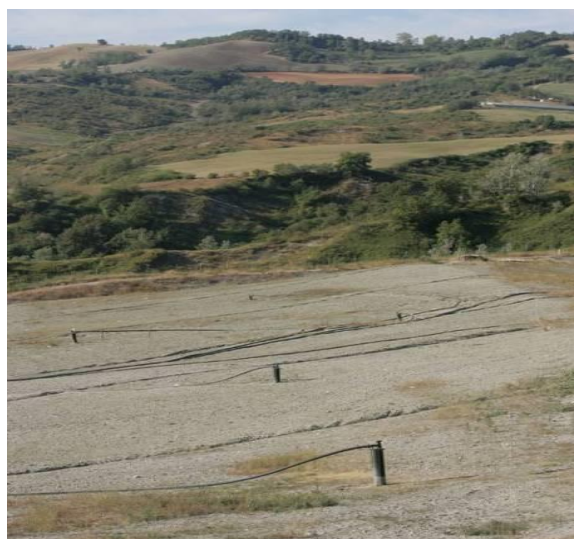
Figura 24 Sistema di estrazione del biogas
