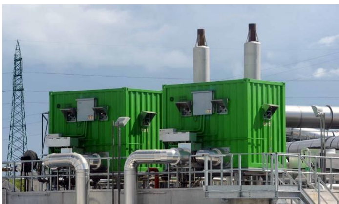
Figura 32 Punti di emissione cogeneratori (E5, E6)
