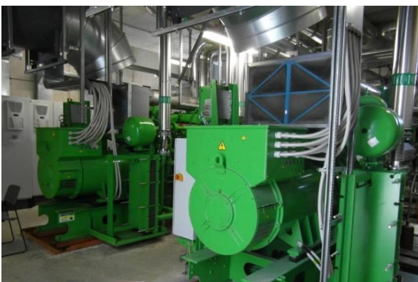
Figura 9 Gruppi di cogenerazione
