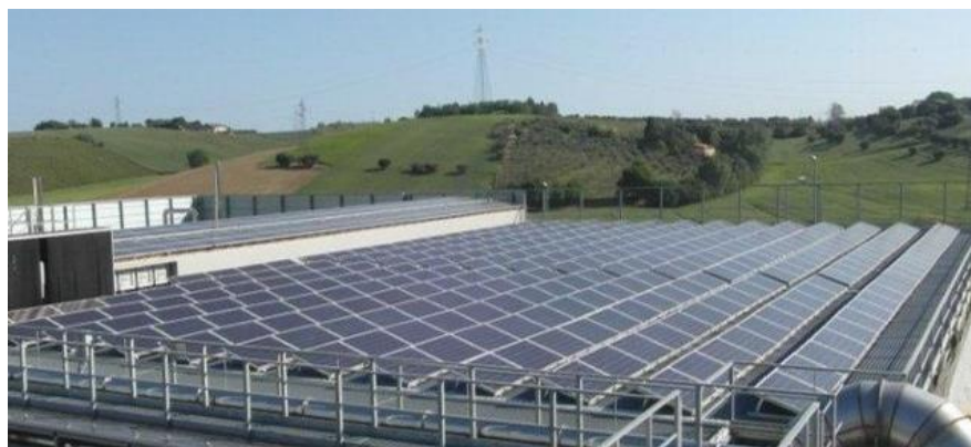
Figura 18 Impianto fotovoltaico sulla copertura dell'edificio di miscelazione e raffinazione
