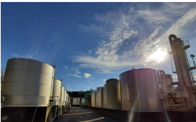
Figura 9 Serbatoi di stoccaggio del percolato
