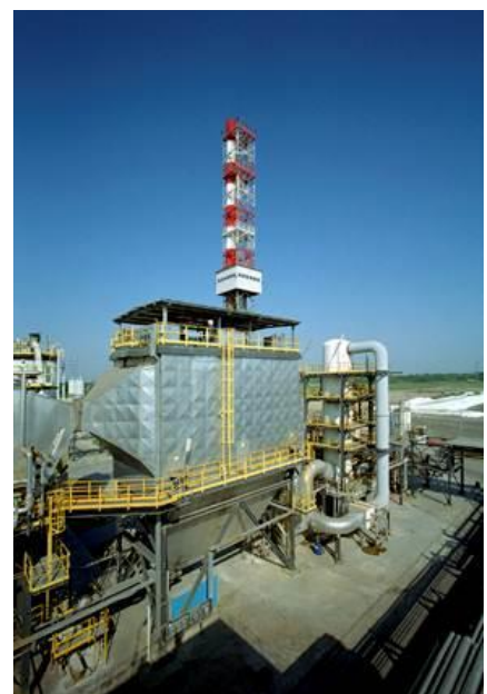
Figura 10 Sezione di depurazione fumi (F3)
