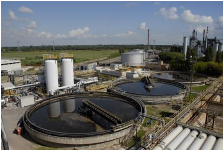
Figura 16 Vasche di sedimentazione
