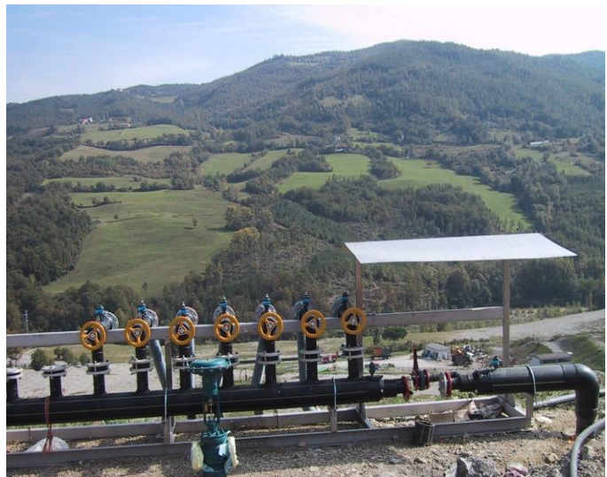
Figura 5 Impianto captazione del biogas
