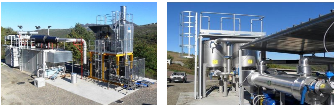
Figura 7 Motogeneratore per la produzione di energia elettrica da biogas
