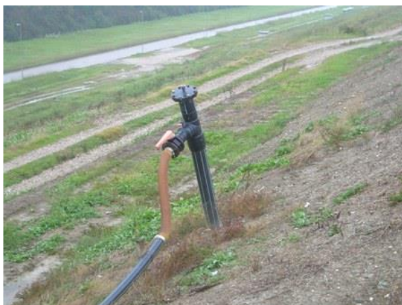
Figura 13 Testa di pozzo
