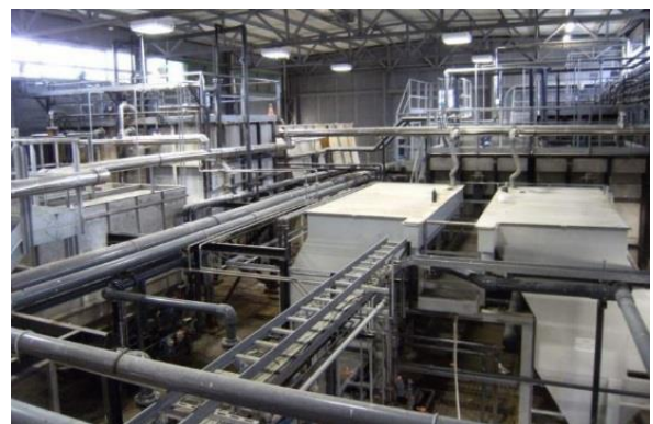
Figura 20 Particolare sezione di trattamento chimico-fisico (1° e 2° stadio)
