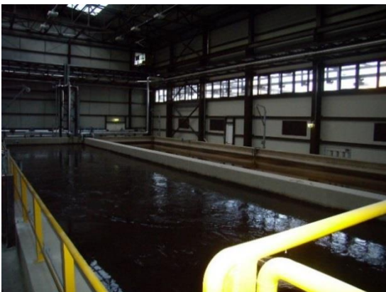
Figura 26 Vasca di stoccaggio fanghi pompabili pericolosi
