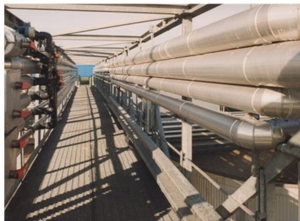
Figura 18 Tubazioni di trasporto del rifiuto liquido in ingresso
