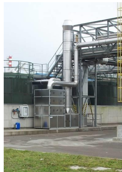
Figura 45 Sistema di trattamento delle emissioni
