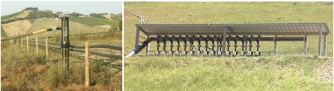
Figura 22 Testa di pozzo e Sottostazione in cui convergono le condotte di captazione del biogas
