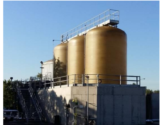
Figura 21 Sistema di accumulo presso Depuratore
