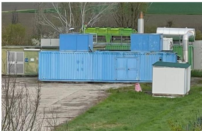
Figura 14 Impianto di produzione di energia elettrica
