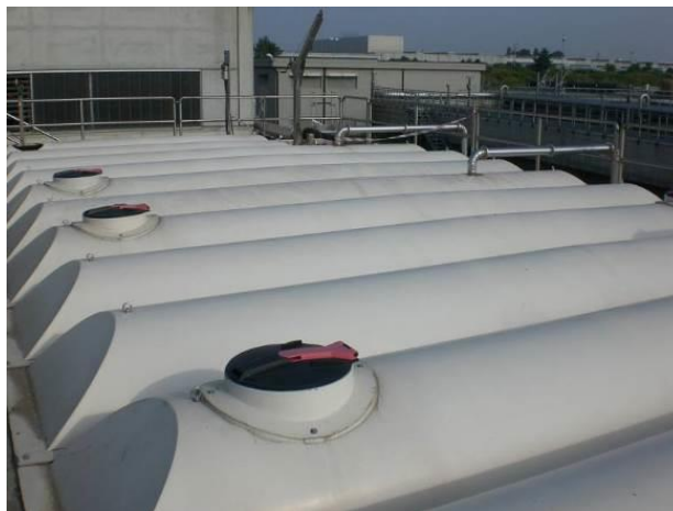
Figura 35 Copertura vasca di stoccaggio VP
