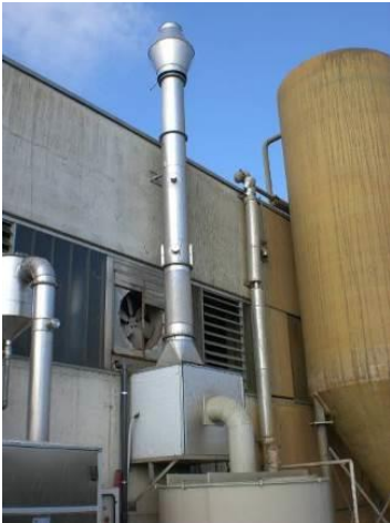
Figura 34 Camino impianto di deodorizzazione
