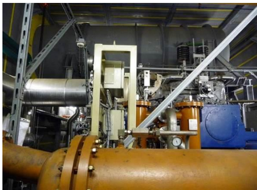
Figura 12 Particolare della sala turbina
