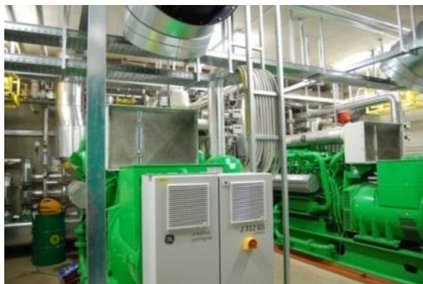
Figura 14 Gruppi di cogenerazione
