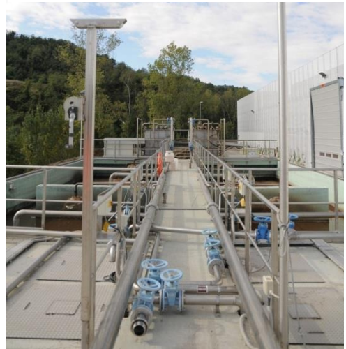
Figura 18 Depuratore biologico interno
