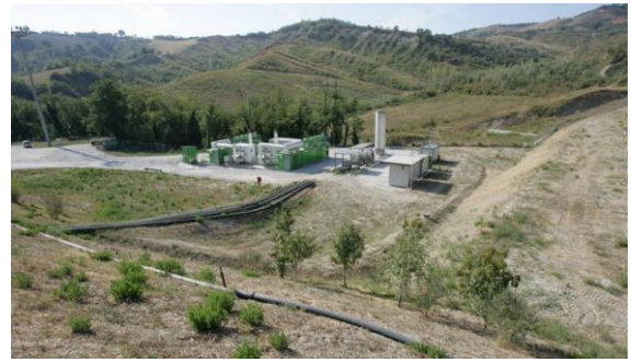
Figura 45 Impianto di recupero energetico
