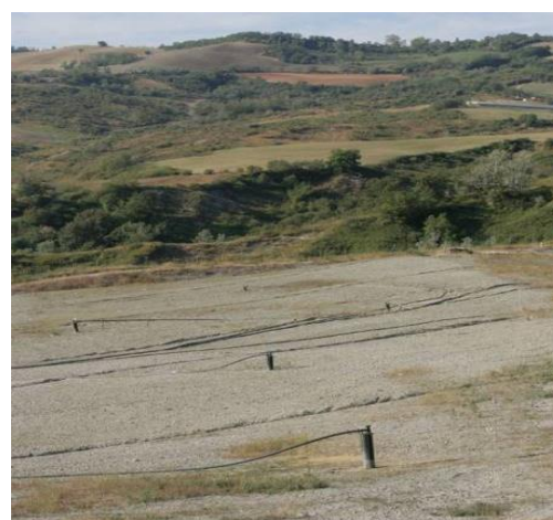
Figura 24 Sistema di estrazione del biogas
