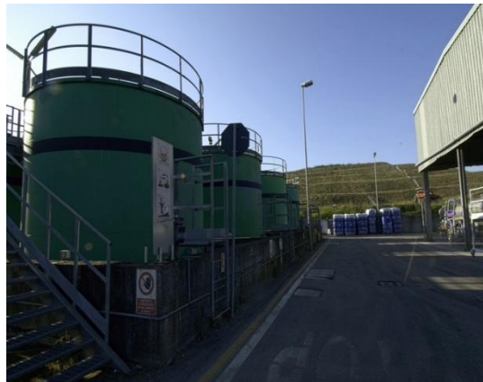
Figura 10 Serbatoi per lo stoccaggio di rifiuti liquidi
