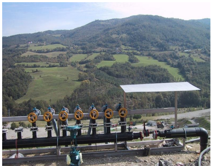
Figura 5 Impianto captazione del biogas
