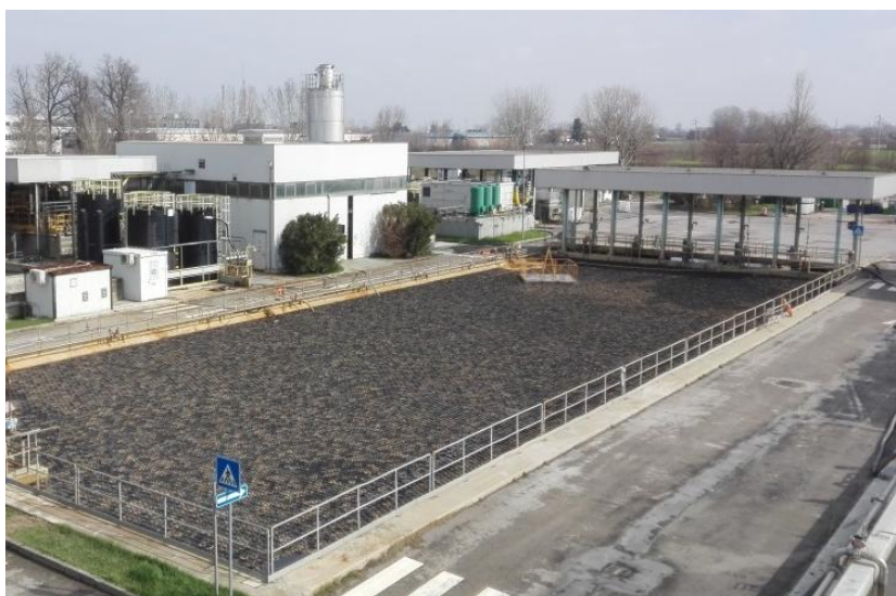
Figura 15 Vasca di sedimentazione primaria
