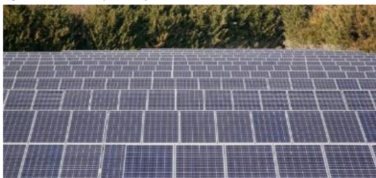
Figura 4 Particolare pannelli fotovoltaici
