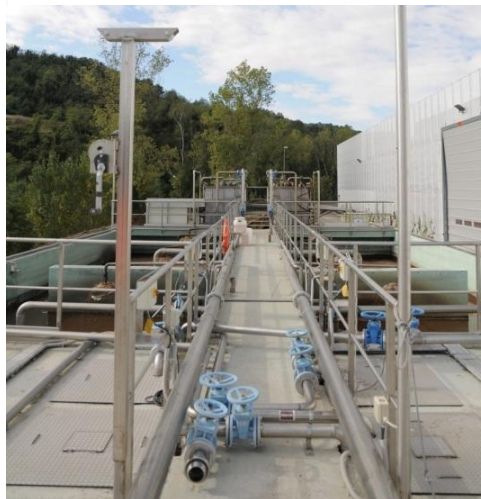
Figura 18 Depuratore biologico interno
