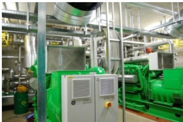
Figura 14 Gruppi di cogenerazione
