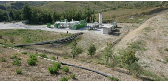
Figura 45 Impianto di recupero energetico
